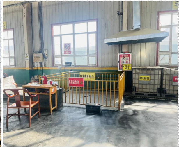
事故池、导流槽及危险废物暂存处
